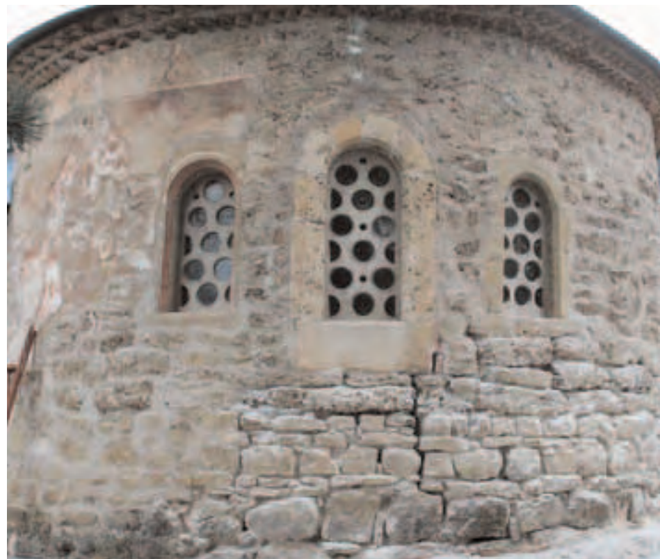
Сл. 45 - Изглед олтарске апсиде цркве Св. Апостола са пукотином која се пружа од венца до темеља (очишћена у доњој зони зида)
