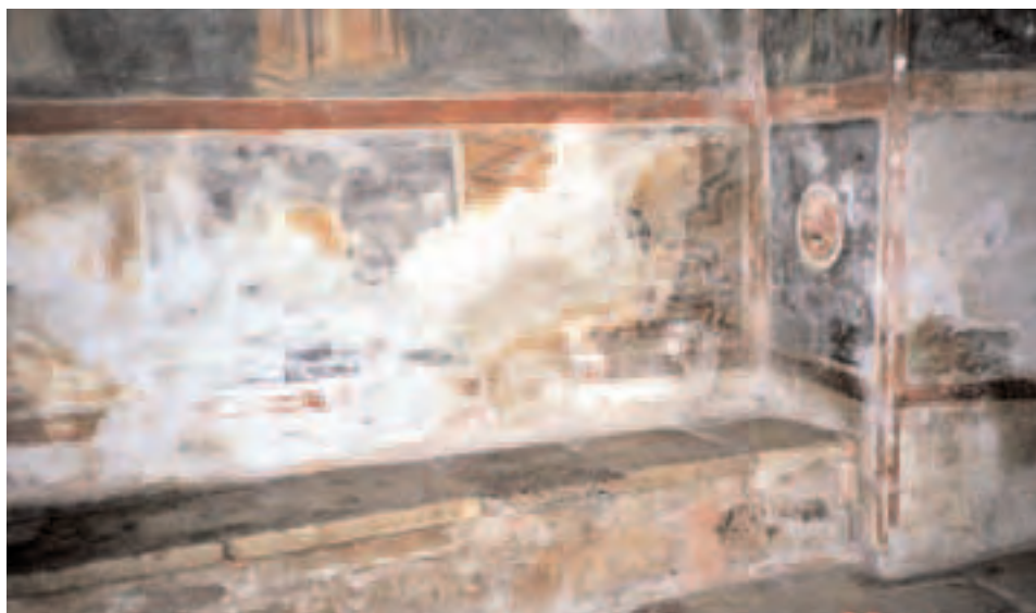
Сл. 32 - Изглед западног зида припрате са јаким исољавањем у доњој зони зидова услед продора воде кроз неомалтерисане зидове и капиларног пењања кроз бетонске облоге темеља
