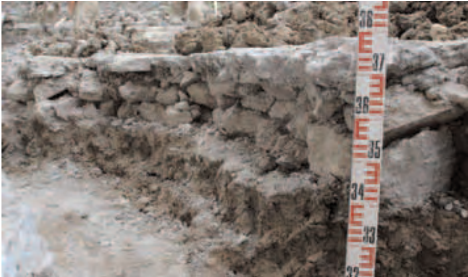
Сл. 41 - Дебели слој ломљеног бетона испод тротоара је као дренажа спроводио воду из околног терена ка темељима цркве Св. Апостола
