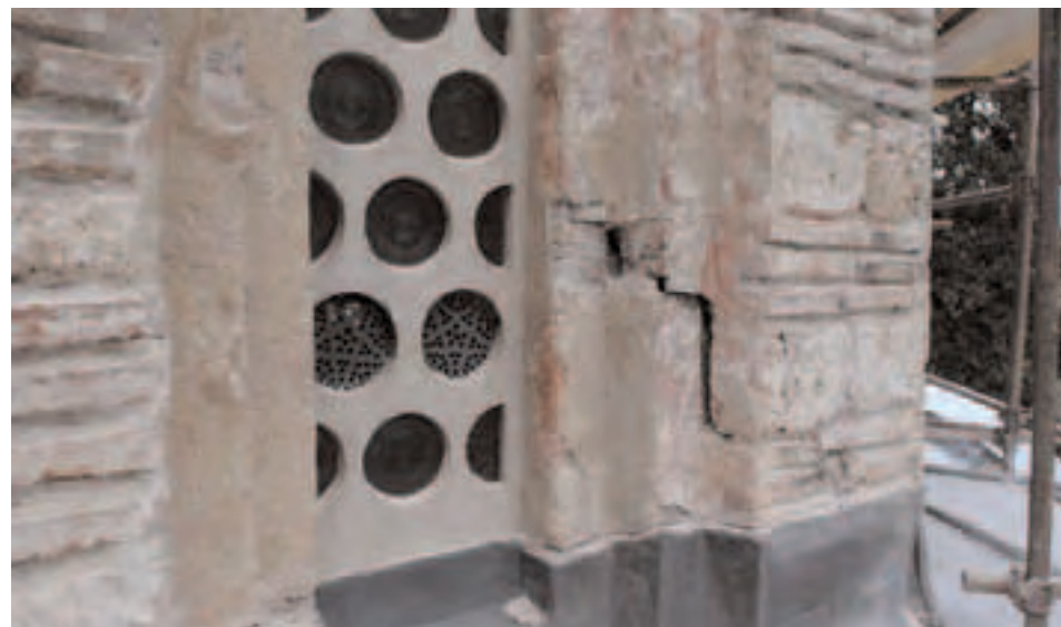
Сл. 74 - Изглед јужне стране тамбура Богородичине цркве са прозорским ступцем пресеченим пукотином која је била покривена продужним малтером
