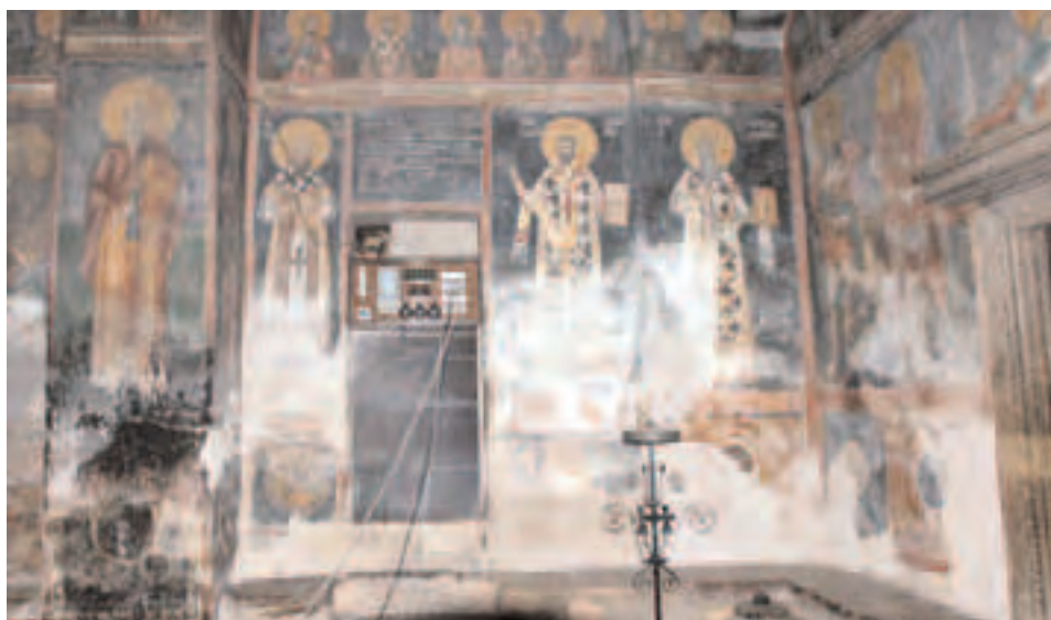
Сл. 33 - Изглед северног зида припрате са јаким исољавањем услед продора воде кроз неомалтерисане фасадне зидове
