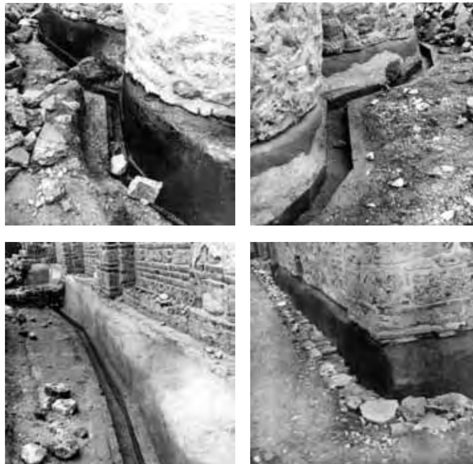
Сл. 6-9 - Изглед бетонског канала и темеља цркве Св. Апостола и западног зида припрате, који су облепљени бетоном и битуменом 1962. године
