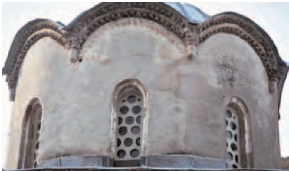
Сл. 19 - Изглед куполе цркве Св. Апостола, са остацима избледелих украса и фасадног малтера који је потпуно изгубио црвену боју
