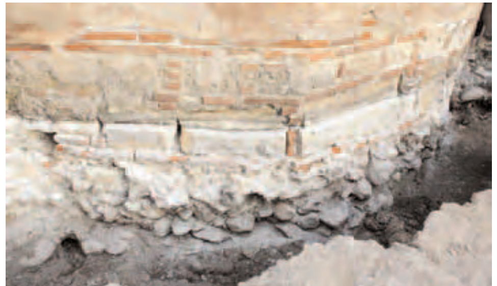
Сл. 62 - Изглед растрешених темеља апсиде Богородичине цркве по уклањању бетонских канала и облоге
