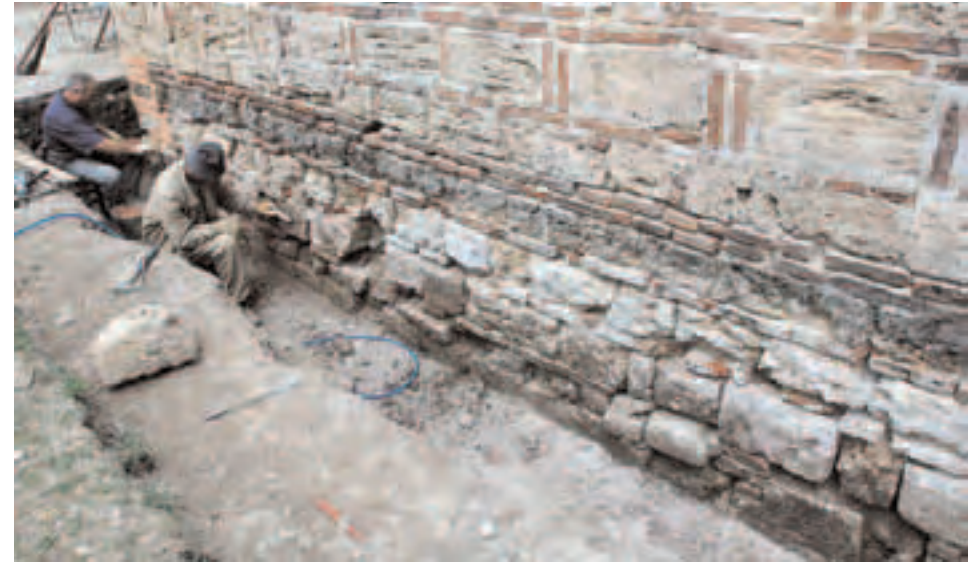
Сл. 136 - Изглед темеља јужног зида цркве Св. Николе, после уклањања бетонског канала и цементне облоге - сига и опека којом су зидани темељи су нагрижени дуготрајним дејством влаге
