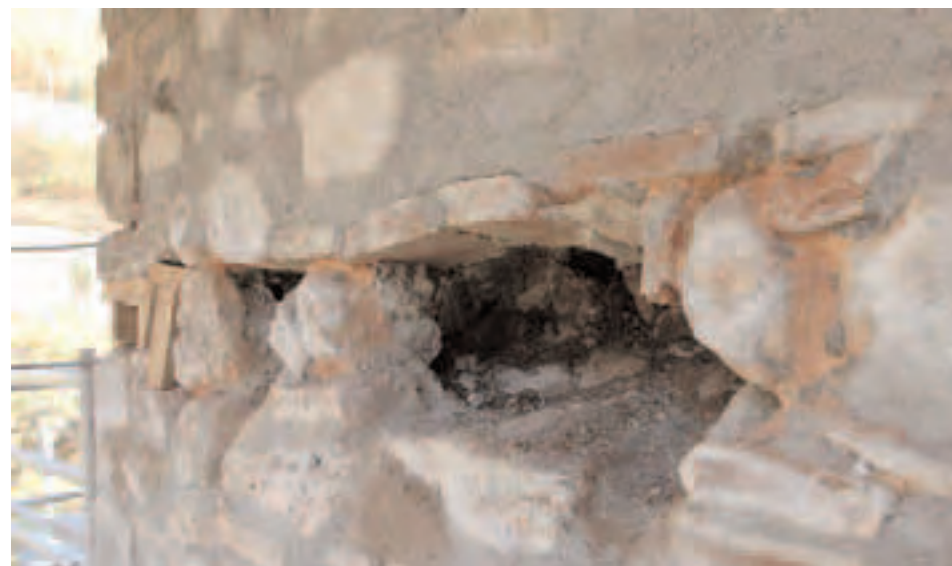
Сл. 126 - Изглед северног дела западне фасаде припрате, иструлели сантрач на висини од четири метра висине био је узрок настанка пукотина у фасади, рупа се пружала дуж северне половине фасаде
