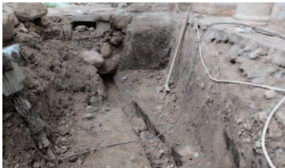
Сл. 109 - Изглед темеља западног зида припрате са доњим и горњим бетонским каналом и бетонском облогом темеља; вода из доњег канала није могла да отекне због затворених одвода ка упојним бунарима
