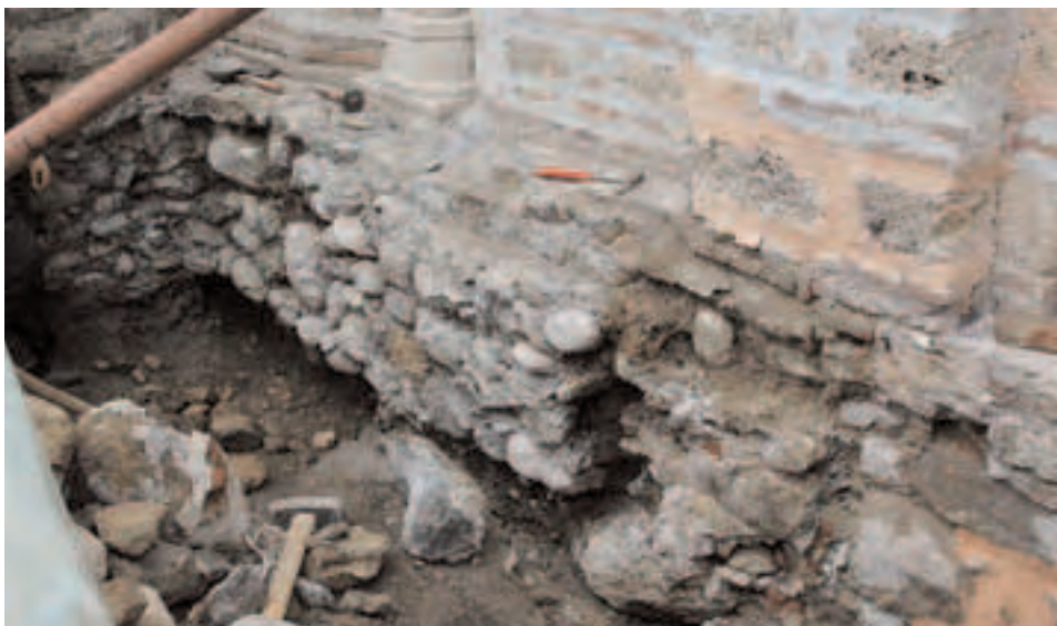
Сл. 120 - Изглед темеља западног зида припрате, очишћеног од бетонске облоге; растрешени темељи, ослабљени несталим сантрачима, узрок су пукотина у западном зиду и надвратнику западних врата
