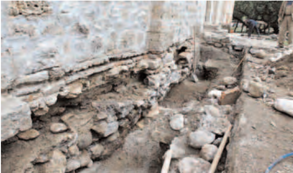
Сл. 116 - Изглед темеља северног дела западног зида припрате, после чишћења темеља од бетонске облоге; труљењем и нестанком дрвене греде у ослонцу зида створени су услови за некадашње рушење припрате
