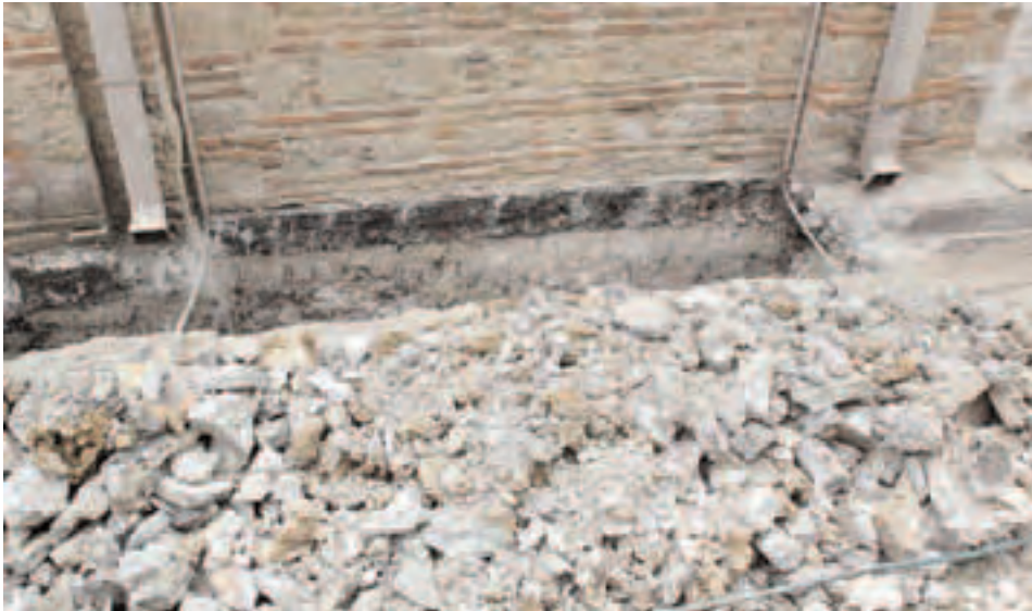
Сл. 81 - Рушењем отвореног бетонског канала са северне стране цркве Св. Димитрија утврђено је да лежи на маси бетона
