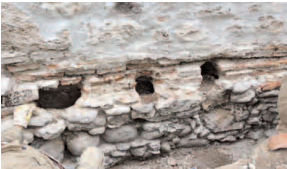
Сл. 105 - Изглед темеља приправе са северне стране, после уклањања бетонске облоге показало се да је дрвена греда, сантрач, потпуно иструлила и да је од ње остала само шупљина
