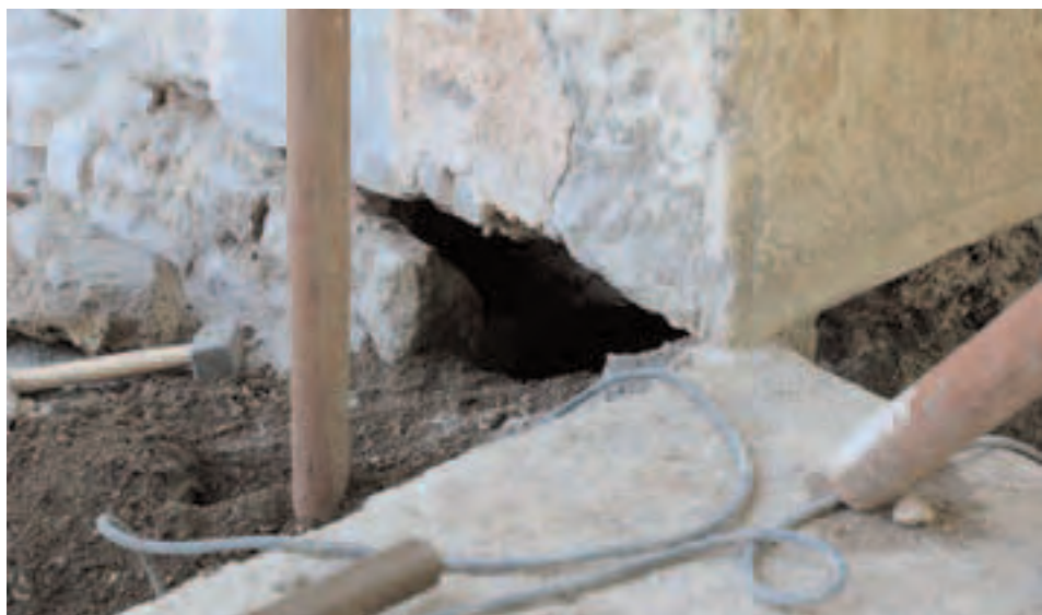
Сл. 121 - Угаони камен, на југозападном углу припрате, почивао је на укрштеним сантрачима, који су иструлели и чије трасе су биле пуне земље; тротоар из 1983. године је само прислоњен уз земљу испод каменог блока
