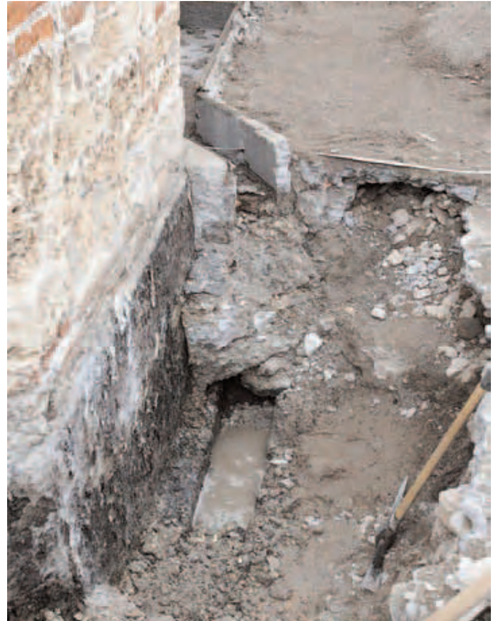
Сл. 130 - Изглед темељне зоне апсиде цркве Св. Николе - отворени бетонски канал је лежао на маси бетона којом је испуњен простор до доњег бетонског канала пуног заробљене воде
