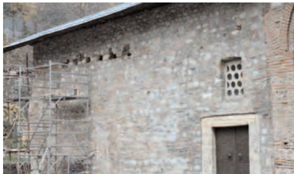
Сл. 123 - Изглед северног дела западне фасаде припрате, иструлели сантрач је нађен и на четири метра висине и био је узрок настанка пукотина у фасади
