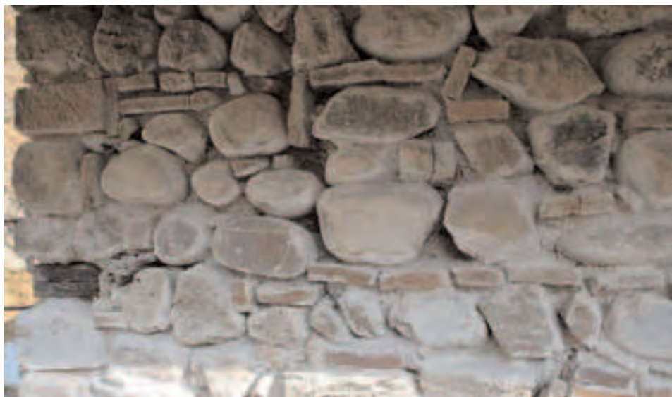
Сл. 125 - Детаљ северног дела западне фасаде припрате, после чишћења зида од продужног малтера; на местима прслина у малтеру су широке несаниране пукотине, неке испуњене земљом
