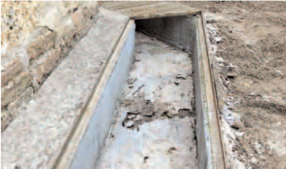
Сл. 128 - Изглед отвореног бетонског канала са источне стране цркве Св. Николе, пре почетка демонтаже; пластифицирана облога канала (вероватно полицем) је пропала и бетон је пропуштао воду
