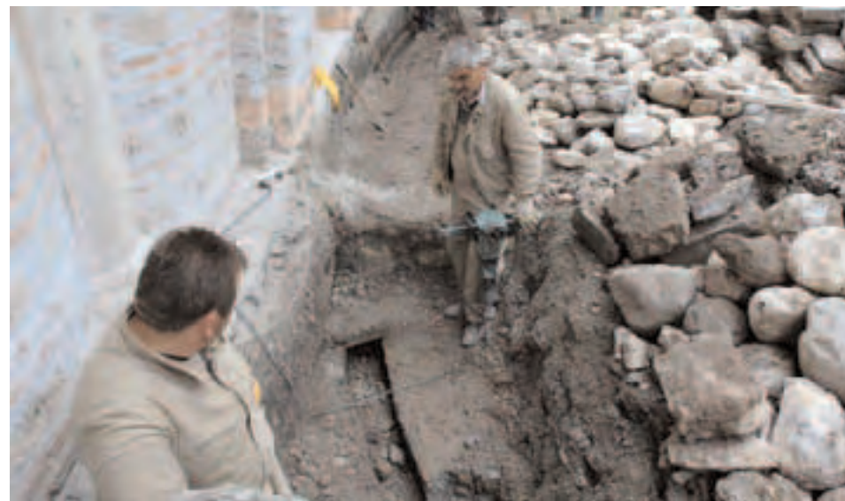
Сл. 110 - Изглед темеља западног зида припрате са доњим бетонским каналом који је са својом испуном од крупних облутака сабрао воду из околног терена и спроводио је до темеља
